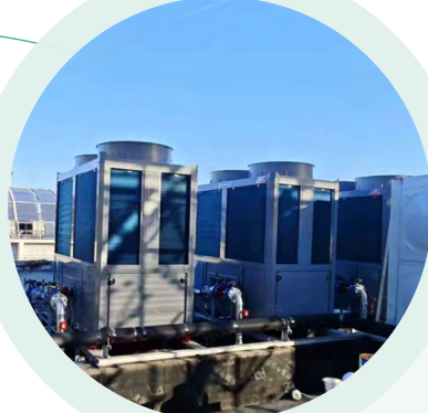
▲ 空气源热泵技术应用
